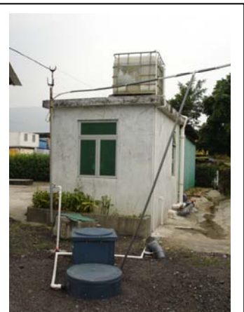
加裝水箱 + water tan
